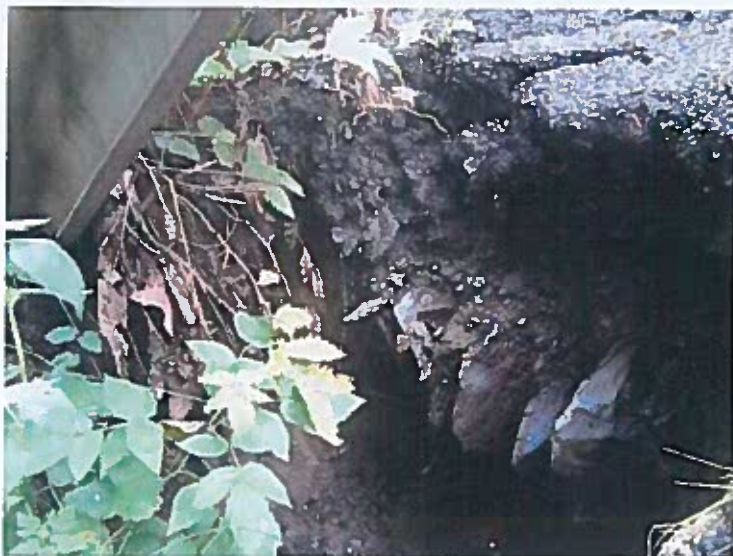
Podemletá krajnice a zničené křídlo.
